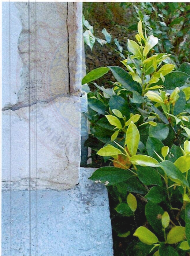
ภาพที่ 29 แสดงความเสียหายในส่วนของคอนกรีตบริเวณม้านั่งเฉลียงอาคาร
