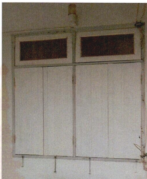
ภาพที่ 50 แสดงรูปแบบหน้าต่างไม้บานเปิดคู่สองช่องมีช่องบานกระทุ้งด้านบน
