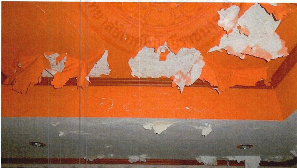
ภาพที่ 35 แสดงความเสียหายในส่วนของการปรับปรุงต่อเติมฝ้าเพดานห้องนอนชั้นบน
