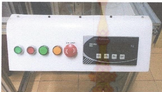
ภาพที่ 3-12 ส่วนระบบแผงควบคุม
