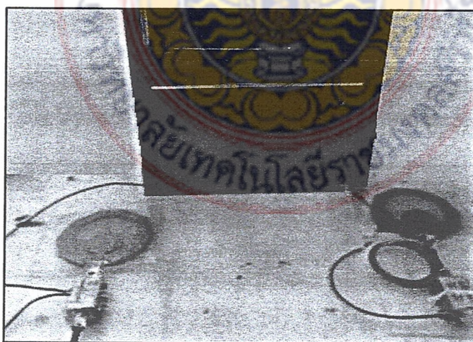
รูปที่ 3.15 การต่อสายไฟให้กับตัวส่งคลื่นไมโครเวฟและตัวรับคลื่นไมโครเวฟ
