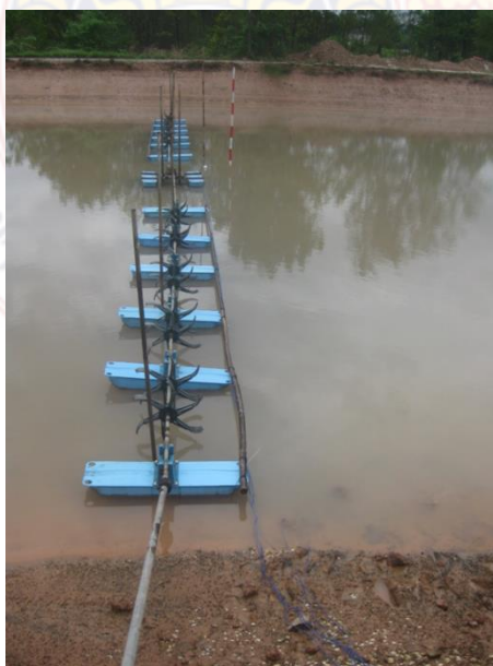
ภาพที่ 2.8 ติดตั้งสายเทอร์โมคัปเปิ้ลต่อน้ำในบ่อเหลือน้อยเพื่อวัดค่าอุณหภูมิของบ่อดิน
