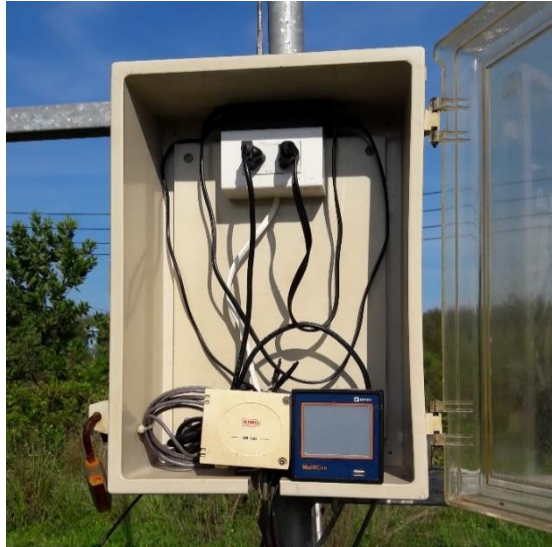
ภาพที่ 2.11 ตู้ควบคุมระบบภายในมีระบบไฟฟ้าและอุปกรณ์
