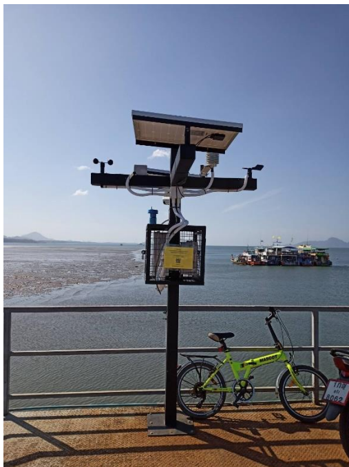
ภาพที่ 3.3 โครงสร้างชุดตู้ควบคุมด้านหน้า
