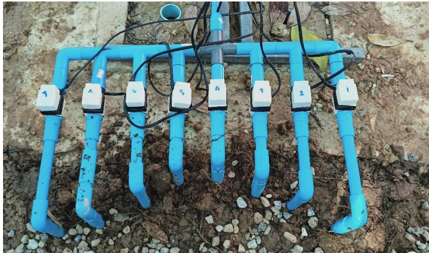
ภาพที่ 3.14 การติดตั้งโซลินอยวาล์วเพื่อควบคุมการเปิดปิดน้ำแต่ละบ่อ
