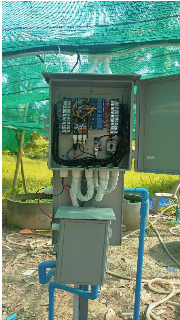
ภาพที่ 3.13 การติดตั้งชุดควบคุมระบบติดตามคุณภาพน้ำและระบบบำบัดน้ำ
